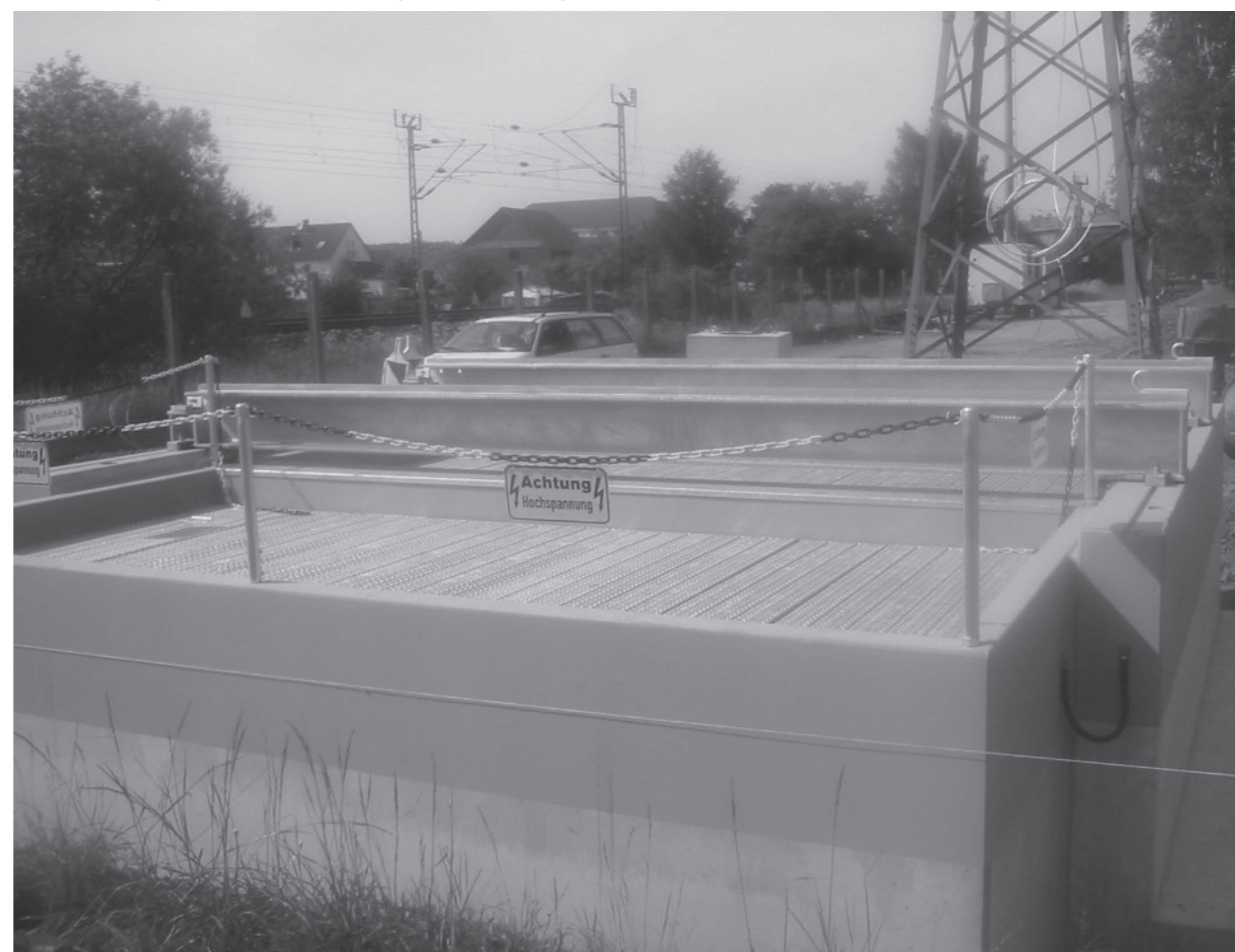
Absperrung HS Seite / Erdungsverbindung
